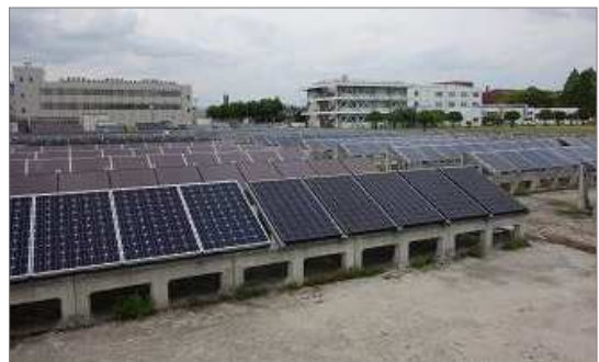
太陽光発電暴露試験施設
