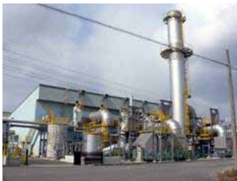
ガスコジェネ発電所
